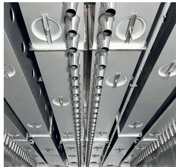
DOPPELKANALSYSTEM in der Heißrauchanlage
